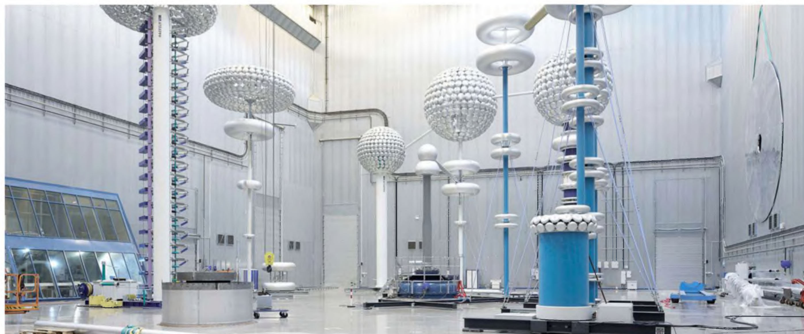
Лаборатория для испытания работоспособности высоковольтного оборудования
