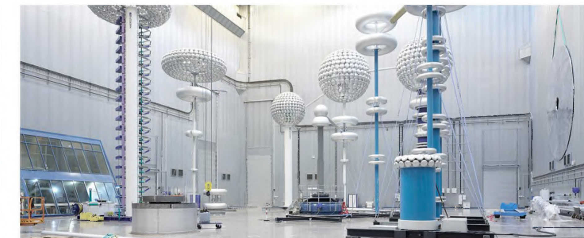
Лаборатория для испытания работоспособности высоковольтного оборудования
