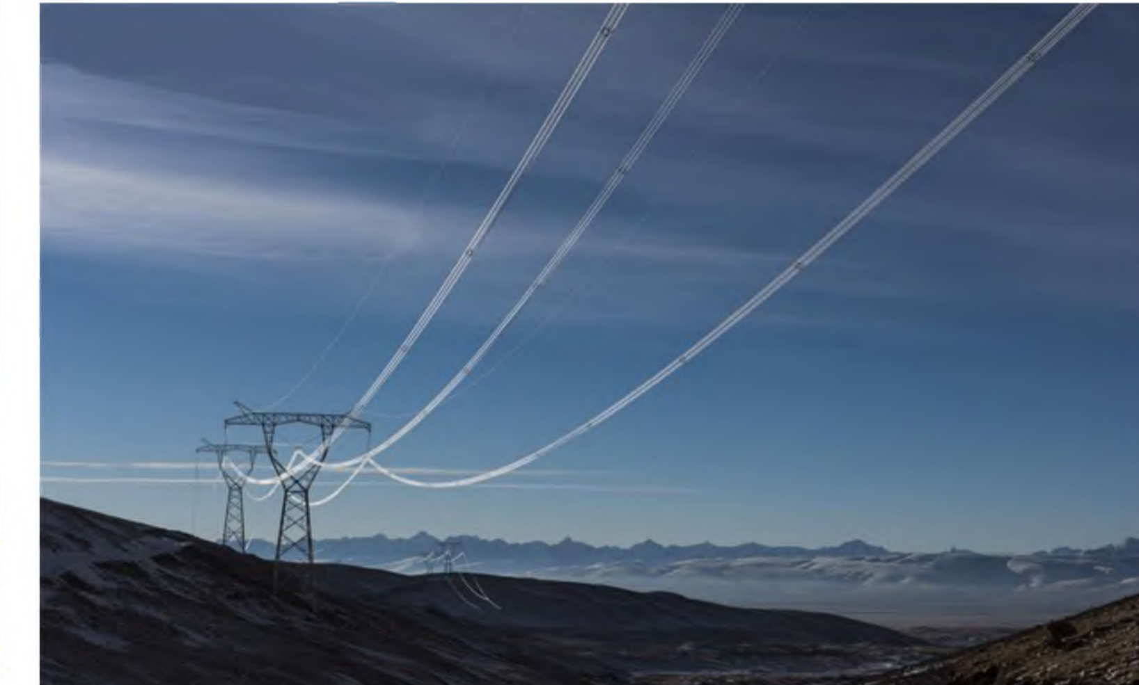
Пилоны высоковольтной ЛЭП постоянного тока Чанцзи – Гугуан (Синьцзян-Уйгурский автономный район, Северо-Западный Китай)
