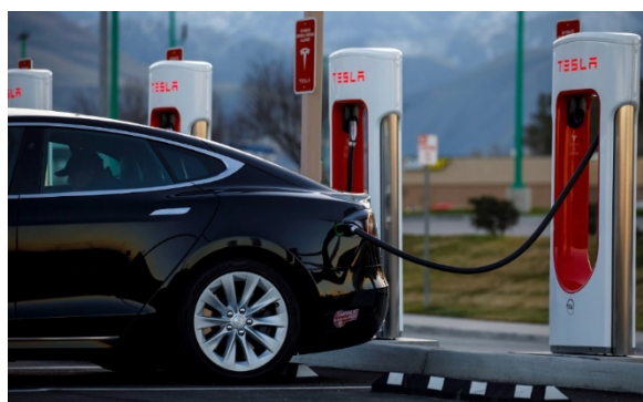
Рис. 4. Станция экспресс зарядки электрокаров
