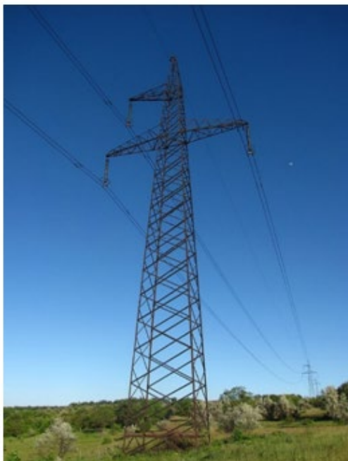
Рис. 1. Промежуточная опора ЛЭП
