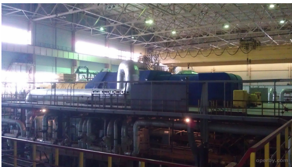
Рис. 1. Турбоагрегат мощностью 320 МВт
