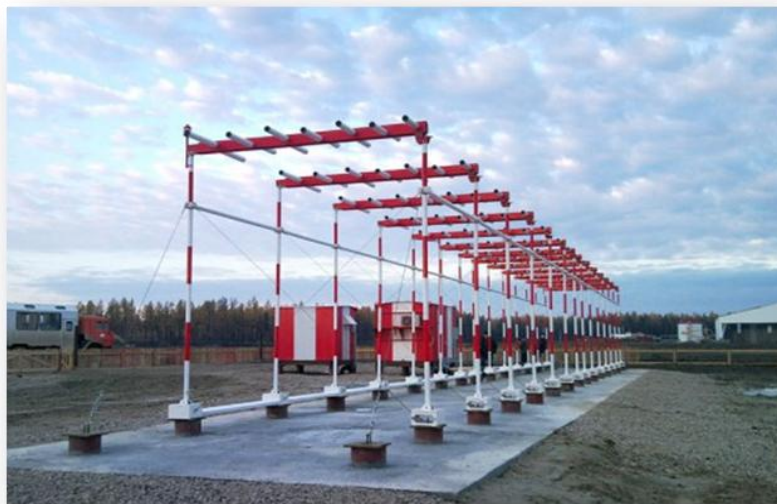
Рисунок П4.5 – Внешний вид наземного оборудования инструментальной системы посадки ILS 2700
