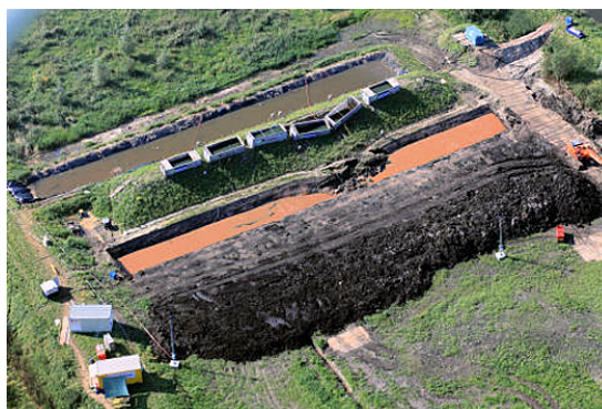
Рисунок 81 — Разрушение дамбы 8.09.2012 в 14:30
